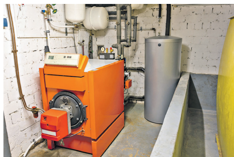
Funktionierende Heizkessel müssen in der Regel nicht ausgetauscht werden.
