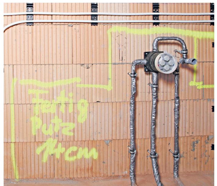
Erneuerbare Energien wie die Wärmepumpe arbeiten am effizientesten mit Flächenheizungen. Im Neubau sind sie fast schon Standard, im Altbau ist der Einbau oft mit hohem Aufwand verbunden. Foto: DJD/Bauherren-Schutzbund
