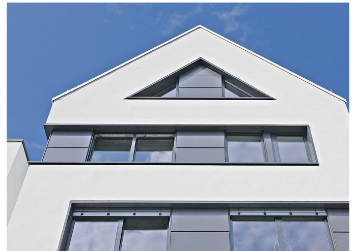
Putzstrukturen werten die Fassade auf und verleihen dem Zuhause ein individuelles Gesicht. Foto: DJD/VDPM
